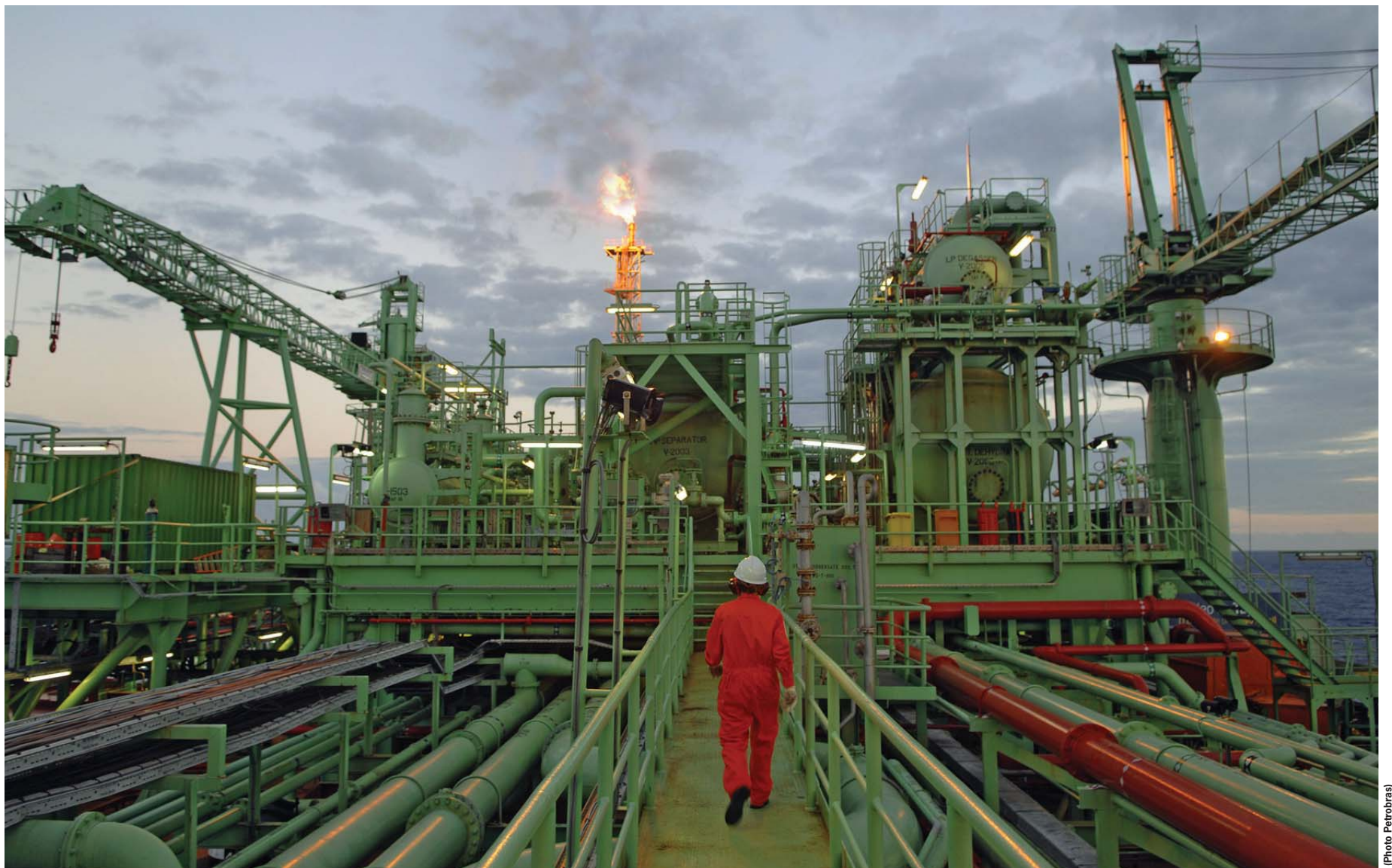
FPSO Cidade de São Vicente deck machinery.
