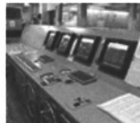
LNG Engine Room Automation
